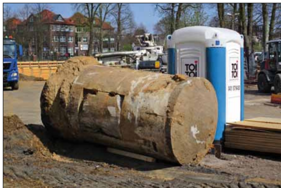
Abb. 2: Bei Bauarbeiten wurden in Bahnhofsnähe in Ahrensburg zwei Splitterbunker geborgen. (Foto: Stadtarchiv Ahrensburg)
