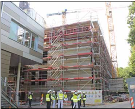
Anfang September besichtigten die Gesundheitsministerin und die Finanzministerin des Landes den Baufortschritt.
